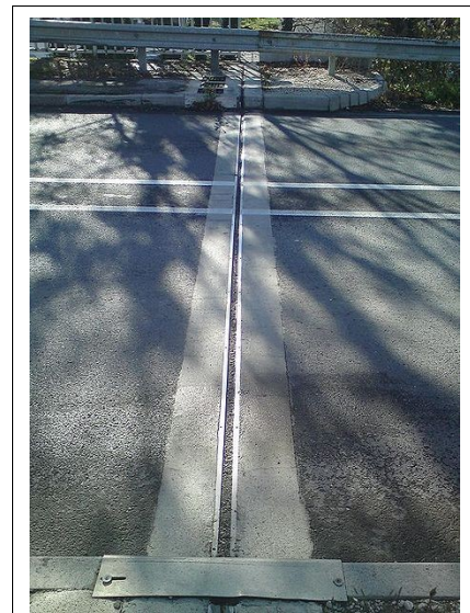
Junta de dilatación en una carretera
