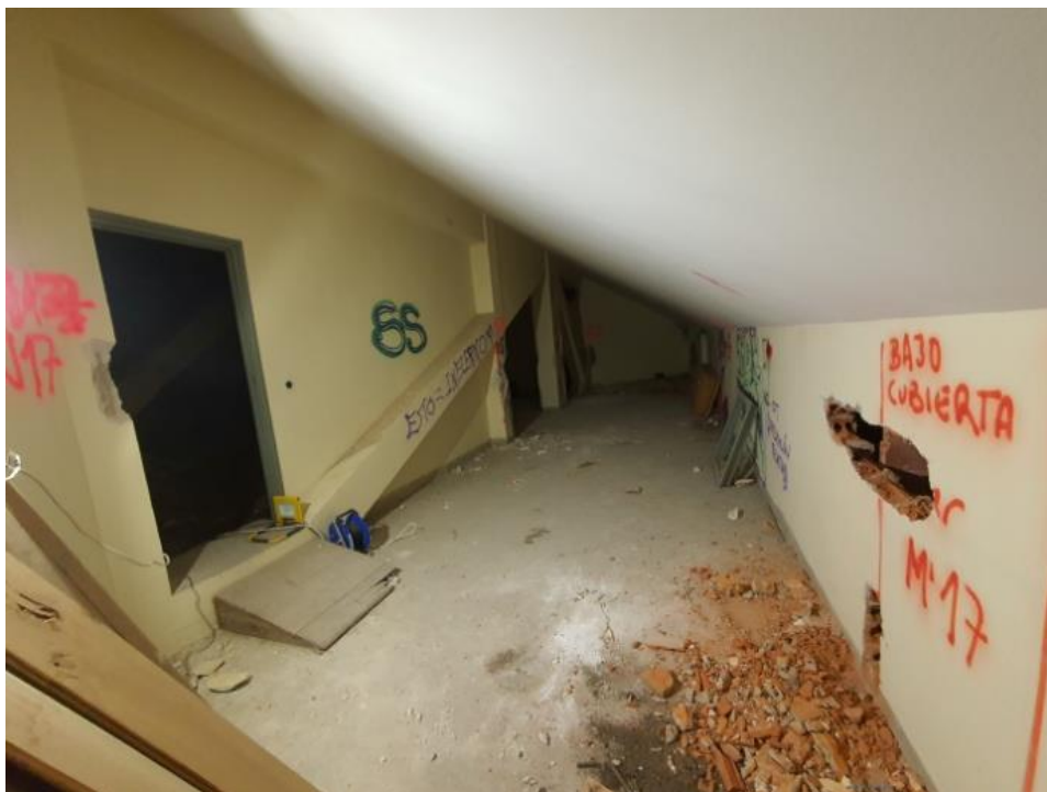
FOTO 117 – Vista general donde se observa la apertura en el muro para caracterizar el apoyo del forjado inclinado de la cubierta.
