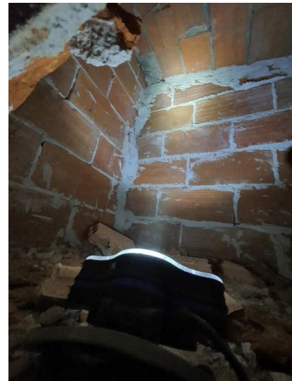
Foto 4. Interior de la cambra donde se observan los taquiques conejeros que sirven de apoyo al forjado de la cubierta.
