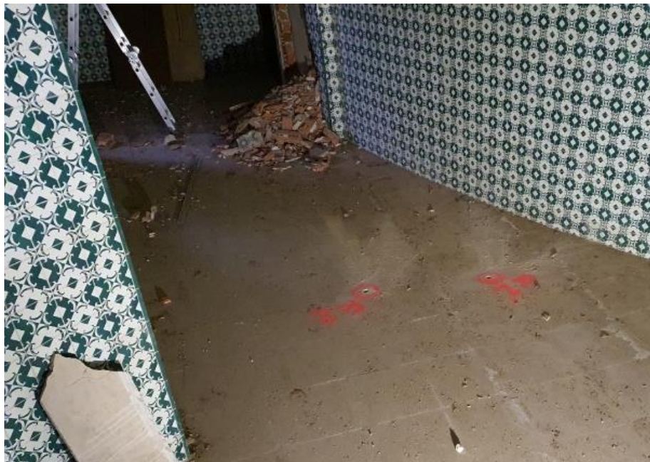
FOTO 16 – Taladros 7 y 8 realizados por INCOSUMA, para verificar la existencia de galerías bajo las eflorescencias.
