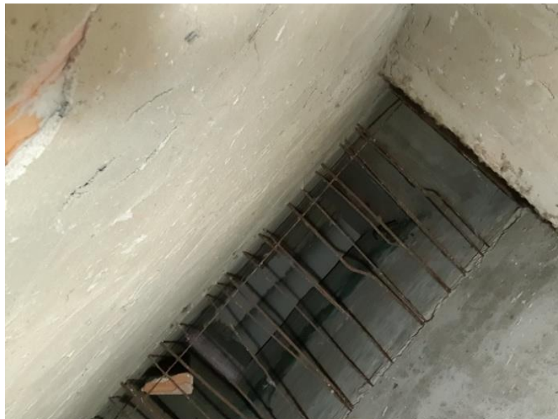
FOTO 86-87 – Vista del interior del hueco, una vez realizada la cata en el muro de partición.
