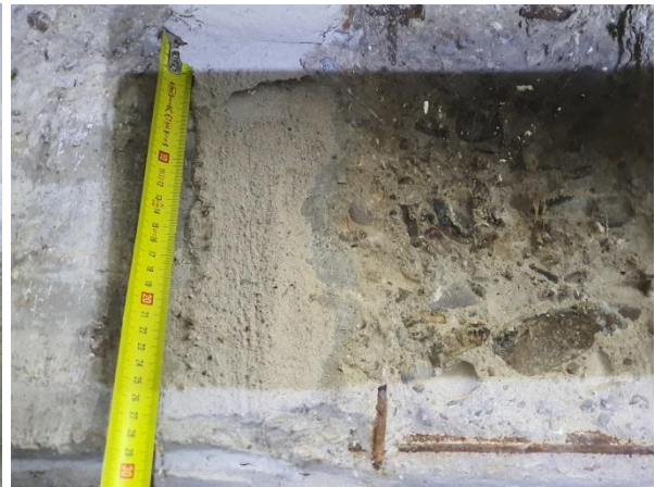
Foto 2. Estribos y armadura longitudinal de la viga con corrosión oxidación
