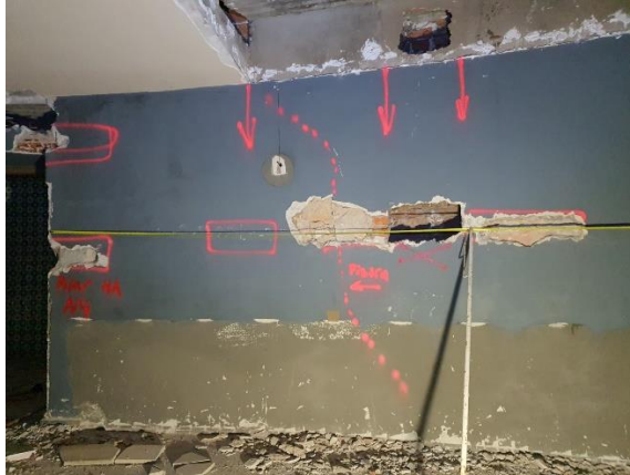
Foto 1. Rozas en muro para determinar la composición de los diferentes tramos de muro.
