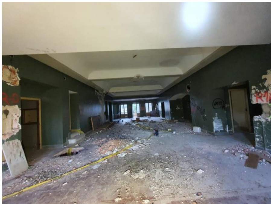
FOTO 113 – Vista general de la cara inferior del forjado de bajo cubierta, donde se han realizado catas por parte de Intemac para caracterizar el forjado.
