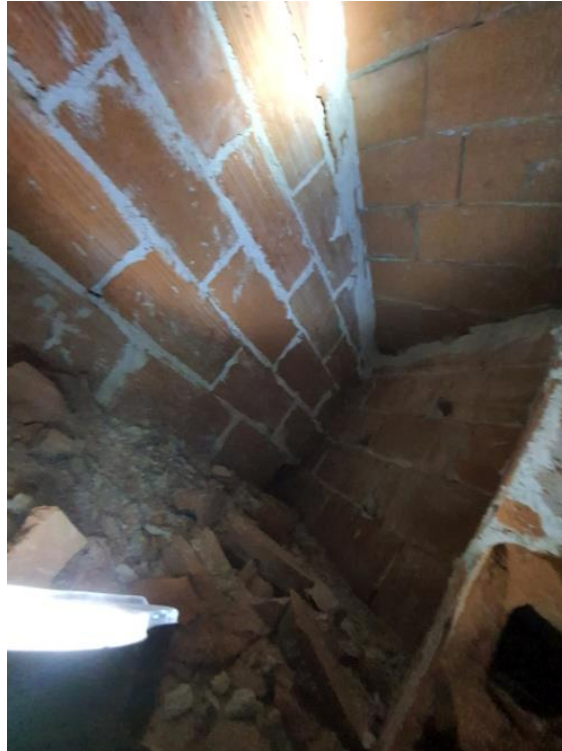
FOTO 120 – Detalle del interior de la cata, donde se observa la disposición de tabiques conejeros, sobre los que se apoya el forjado de cubierta.
