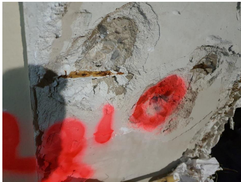
Foto 1-2-3: Vista general y detalle de la cata realizada en el zuncho de borde de la platea alta, para comprobar la existencia del armado inferior. Se observa la elevada oxidación de la armadura.
