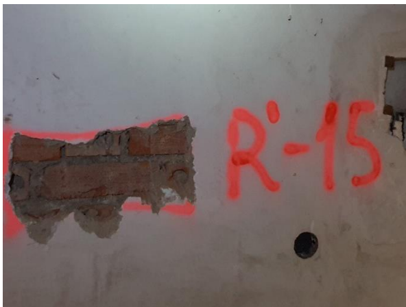
Foto 3. Roza en muro donde se observa fábrica de ladrillo resistente.
