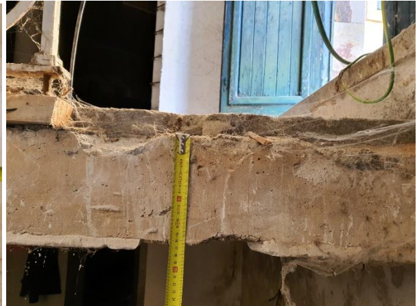
Foto 4. Medida del canto del zuncho de borde en el hueco de la escalera.
