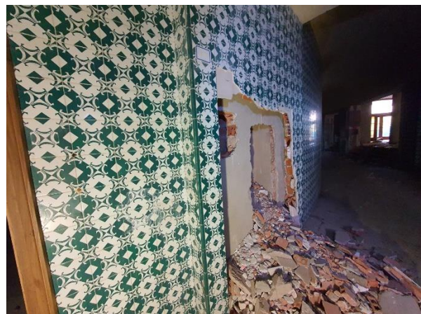
Foto 4. Roza en zona posterior del muro, donde se observan huecos.
