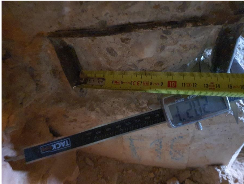
Foto 1. Medición del diámetro de la armadura del pilar y la distancia entre las mismas. Se estima que hay tres armaduras en la cara X del pilar
