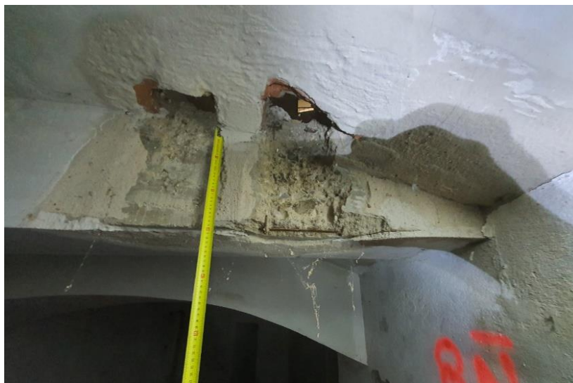
FOTO 65 – Cata 7 realizada por INCOSUMA en la viga y la cara inferior del forjado del escenario.
