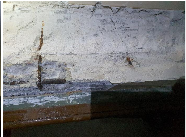
Foto 2. Estribos de la viga con corrosión elevada.
