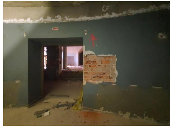
Foto 2. Zona de paso, donde se ha determinado que la zona del ladrillo estaba hueca.
