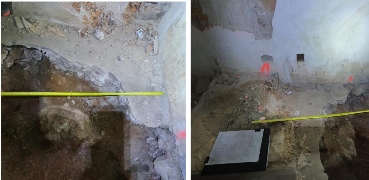
FOTOS 37 y 38 – Cata realizada por Intemac
