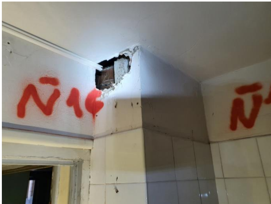
FOTO 111 – Detalle de cata realizada para detectar la existencia del pilar de hormigón.
