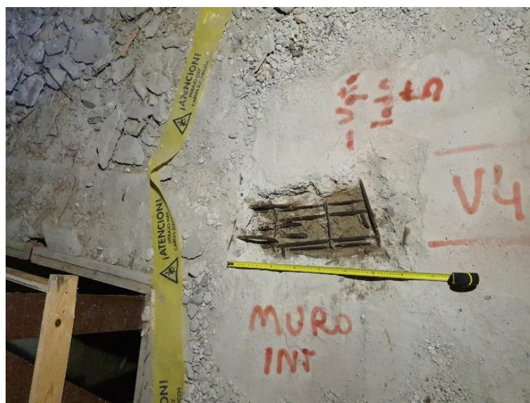
FOTO 60 – Cata 9 de Intemac. Cata de negativos junto al apoyo de la viga en el muro de mampostería
