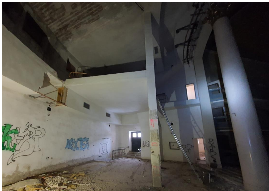
FOTO 106 – Vista general de la cara inferior del forjado de 1ª Planta, en la zona del escenario.
