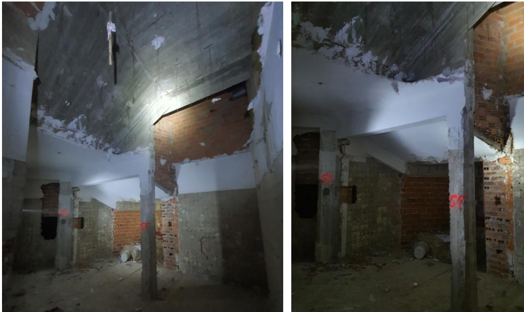
FOTO 91-92 – Vista general de la zona de las escaleras, donde se observa la estructura de hormigón sobre la que apoya la losa.
