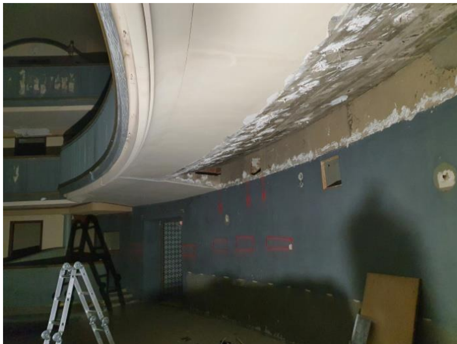
FOTO 97 – Vista general de la cara inferior de la losa en la zona de la platea alta, donde se observa que el final del voladizo es una losa horizontal que está conectada con la inclinada.
