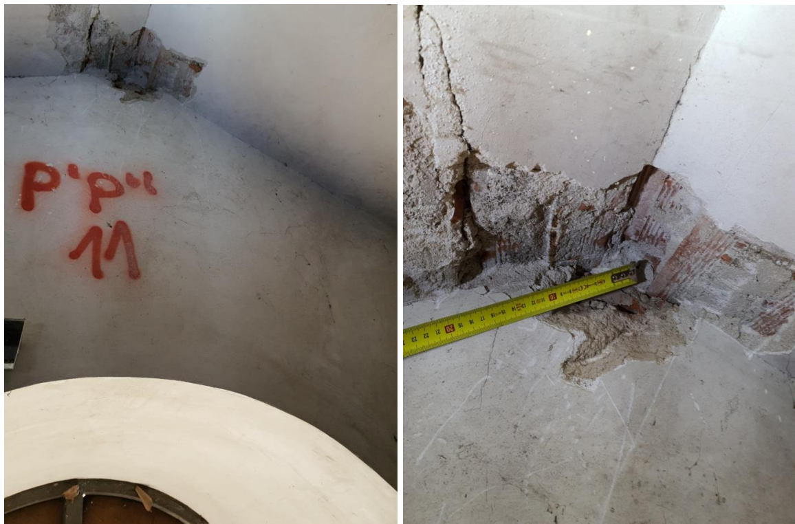
FOTO 123-124 – Vista general y detalle de cata realizada en la cumbre para comprobar el encuentro y apoyo de los forjados inclinados que forman la cubierta.
