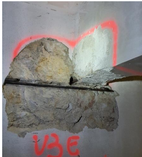
FOTO 46 – Encuentro entre muro de mampostería y viga del forjado del escenario. Viga V3E
