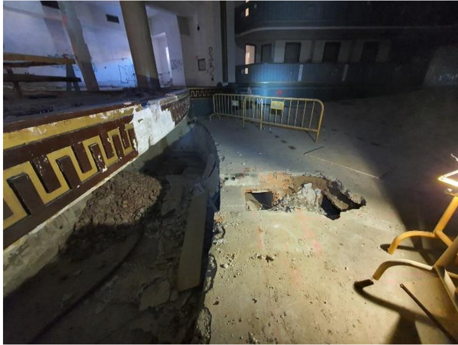
FOTO 17 – Vista general de la cata 8 INC, en la solera inclinada de la platea.
