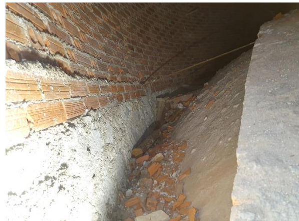
Foto 4: Se observa el muro de mampostería de la 1ª Planta y sobre el que se apoya una fábrica de ladrillo hueco.
