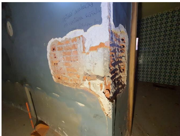
Foto 3. Rozas en muro donde se observa un pilar de hormigón de sección cuadrada-
