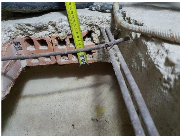
Foto 3. Medida del espesor del forjado Se observa el posible refuerzo del forjado
