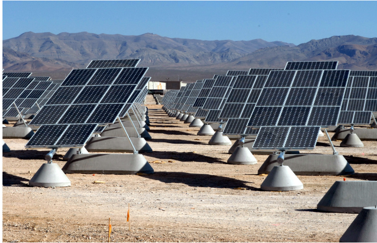
Planta solar situada en la Base de la Fuerza Aérea Nellis (Nevada, Estados Unidos).
