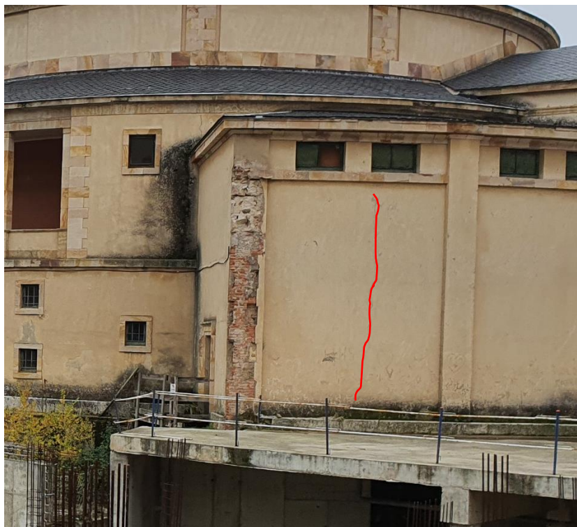
FOTO 4 -Vista general donde se observa pérdida volumétrica del machón en fachada. También, se observa una fisura vertical.
