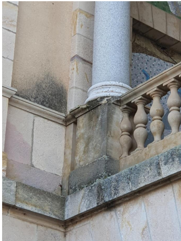
FOTO 10 -Vista general donde se observa un desprendimiento de la piedra, por el posible cabeceo hacia el exterior del pilar de granito.
