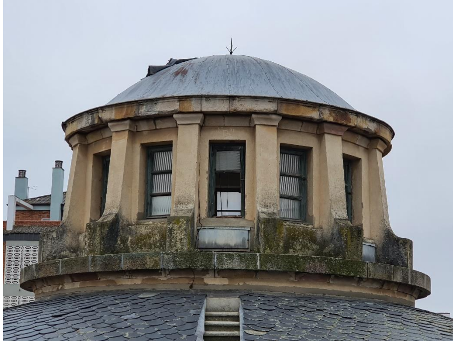
FOTO 5 -Vista general del cimborrio, donde se observa en la parte inferior moho y hongos debido a la incidencia de los agentes atmosféricos.
