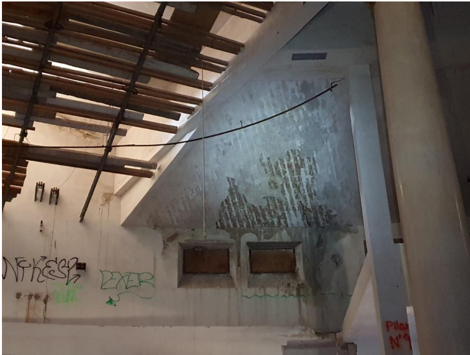
FOTO 11 – Humedad por posibles filtraciones de agua desde la cubierta del edificio. La armadura presenta una alta. Techo 1ª Planta sobre el escenario.
