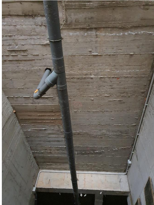
FOTO 11 -Vista general donde se observan fisuras horizontales con eflorescencias por sales en la cara inferior del techo del sótano -1
