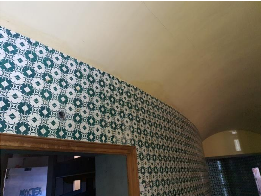
FOTO 6 – Fisura longitudinal y mancha de humedad por posibles filtraciones de agua en la bóveda de cañón. Techo de Planta Baja.
