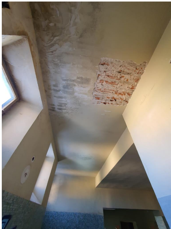
FOTO 10 - Humedad por posibles filtraciones de agua. Techo de 1ª Planta.
