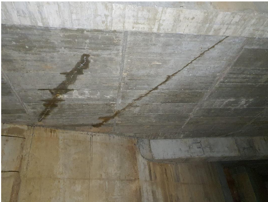
FOTO 8 -Vista general donde se observan fisuras horizontales con eflorescencias por sales en la cara inferior del techo del sótano -2.
