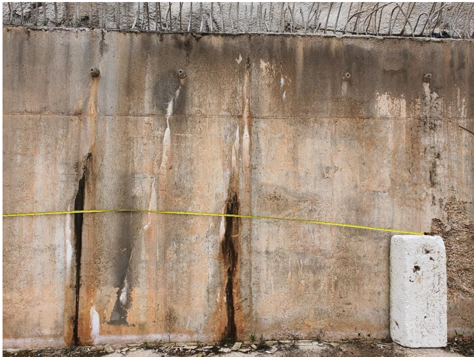
FOTO 1 -Vista general donde se observan fisuras verticales, eflorescencias por sales, hongos y moho. Muro 1.
