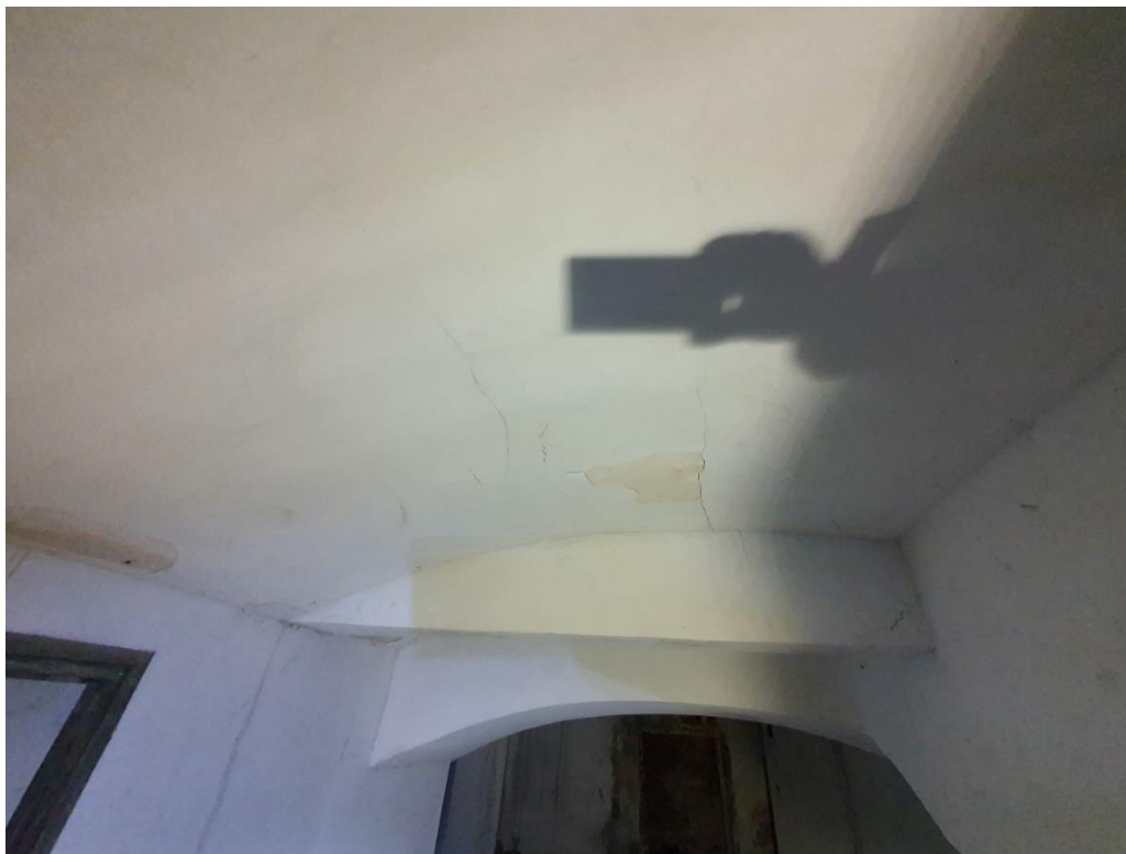
FOTO 2 – Fisuras longitudinales en bóveda de cañón. Techo del sótano bajo el escenario.
