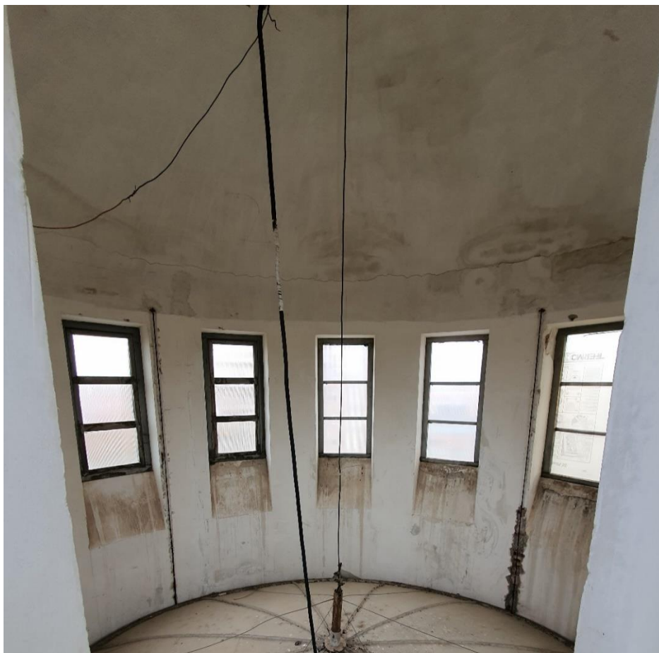
FOTO 18 – Humedad por posibles filtraciones de agua desde la cubierta localizadas en el ciborrio.
