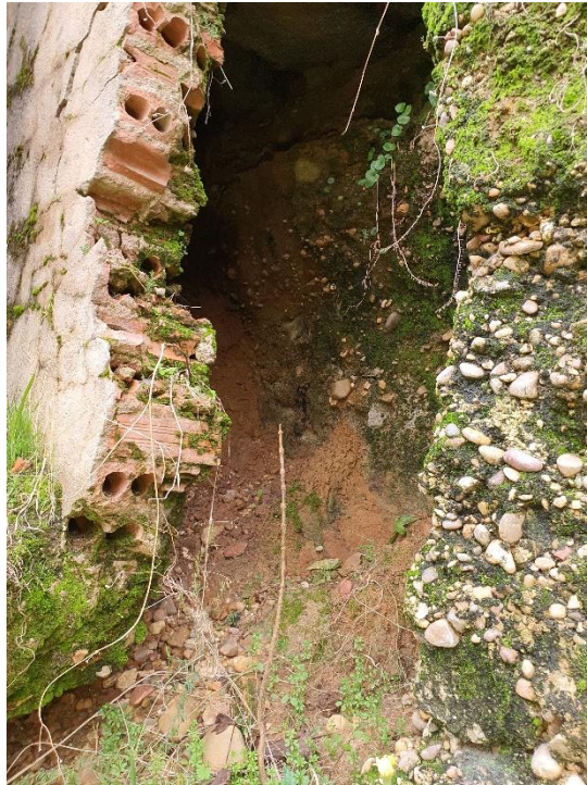
FOTO 1 –Detalle de deslizamiento del talud.
