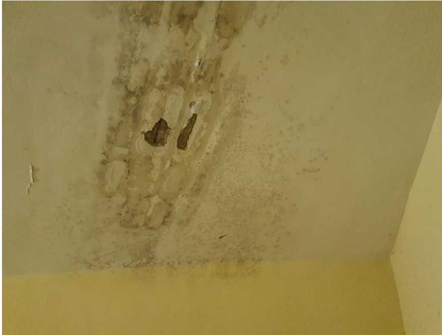
FOTO 15 - Humedad por posibles filtraciones de agua desde la cubierta del edificio. La armadura presenta corrosión. Techo de bajo cubierta.
