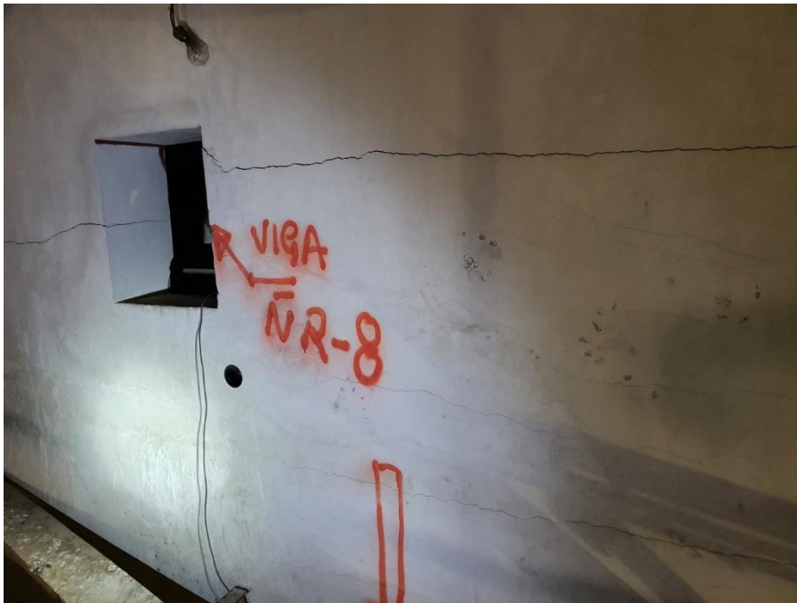
FOTO 16 – Fisuras longitudinales e inclinadas tipo arco de descarga por posible flexión de la viga. Zona sobre el escenario.
