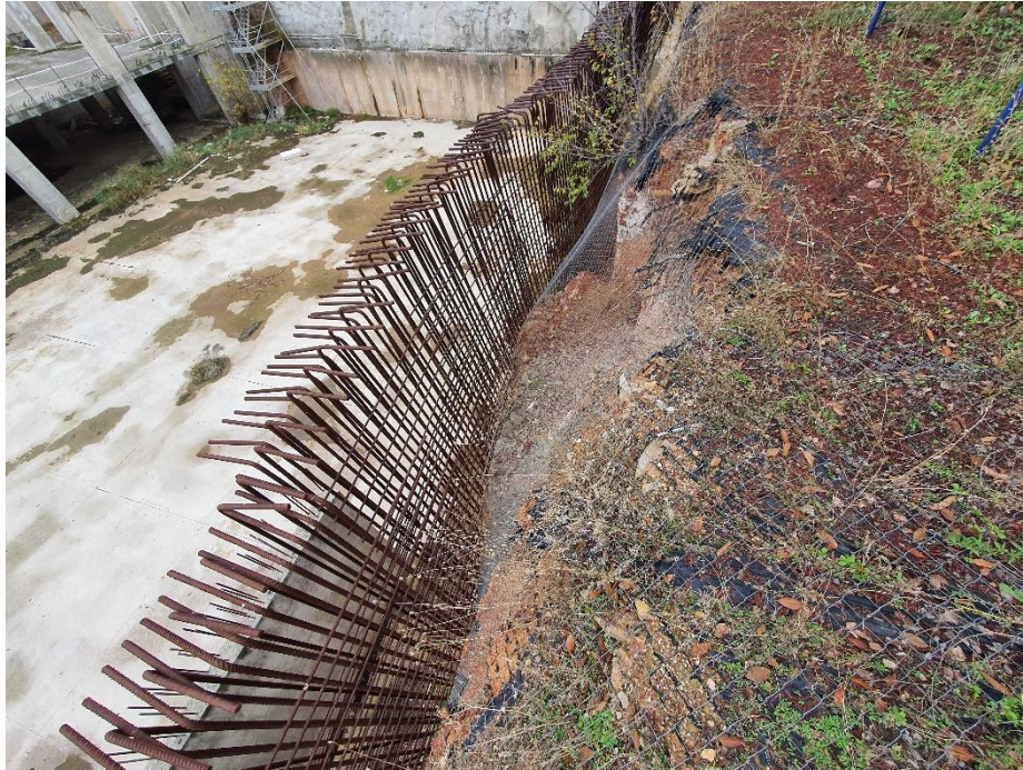
FOTO 9 -Vista general del deslizamiento del terreno, donde se observa una acumulación de las tierras, que generan un empuje sobre el muro y la armadura de espera. En el muro 2.
