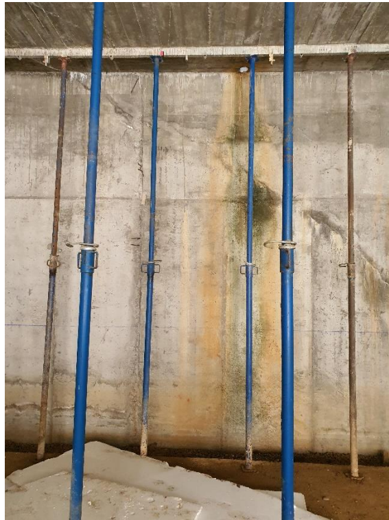
FOTO 3 -Vista general donde se observa fisura inclinada con eflorescencias de sales. También, se aprecia moho y hongos. Muro 3.
