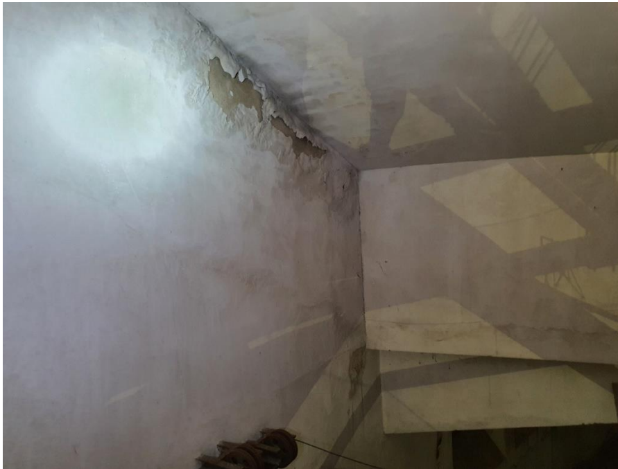
FOTO 17 – Humedad por posibles filtraciones de agua desde la cubierta sobre el escenario.
