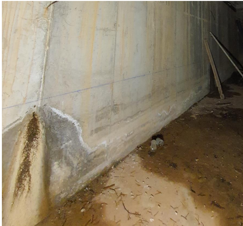
FOTO 5 –Detalle de eflorescencias por sales en la junta entre muros. Muro 5.
