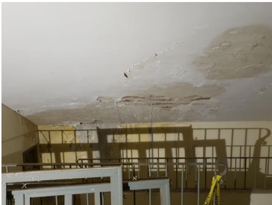
FOTO 12 – Humedad por posibles filtraciones de agua procedentes desde la cubierta. La armadura presenta corrosión. Escaleras acceso a bajo cubierta.
