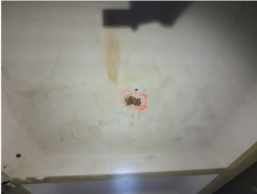
FOTO 9 - Humedad por posibles filtraciones de agua. La armadura presenta una oxidación media. Techo de 1ª Planta sobre el vestíbulo.
