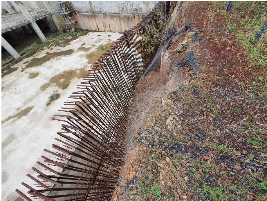
FOTO 9 -Vista general del deslizamiento del terreno, donde se observa una acumulación de las tierras, que generan un empuje sobre el muro y la armadura de espera. En el muro 2.
