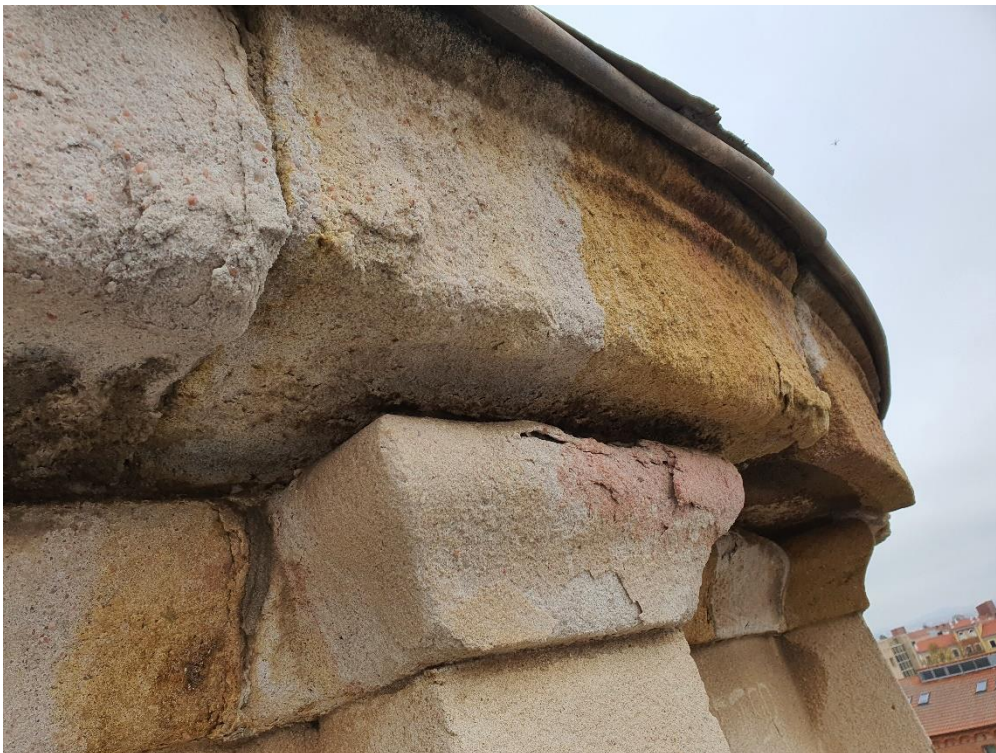
FOTO 6 –Detalle de la erosión de la piedra que forma el anillo superior del cimborrio, debida posiblemente por los agentes atmosféricos.
