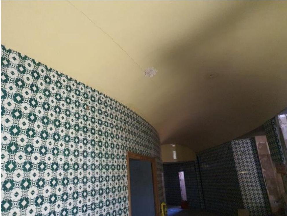
FOTO 5 – Fisura longitudinal en la bóveda de cañón. Techo de Planta Baja.
