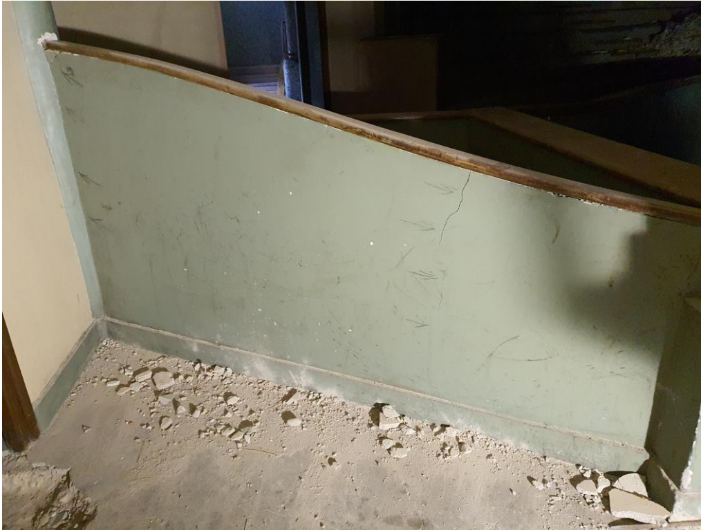
FOTO 7 – Grietas verticales e inclinadas tipo arco de descarga por posible flexión del forjado. Palcos de entreplanta.
