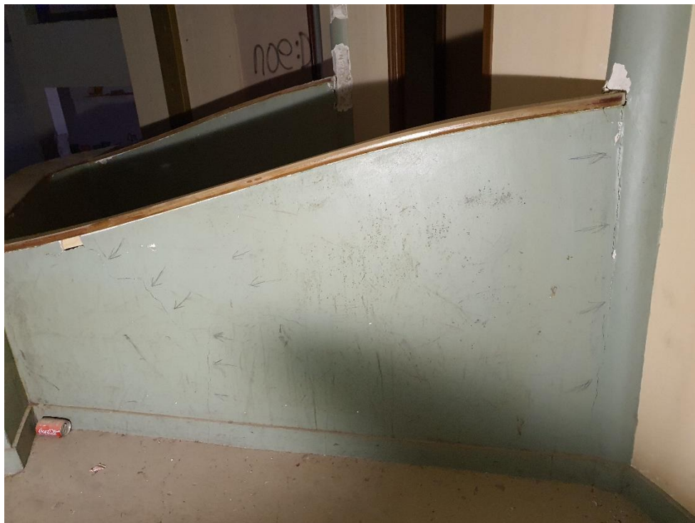
FOTO 8 - Grietas verticales e inclinadas tipo arco de descarga por posible flexión del forjado. Palcos de entreplanta.
