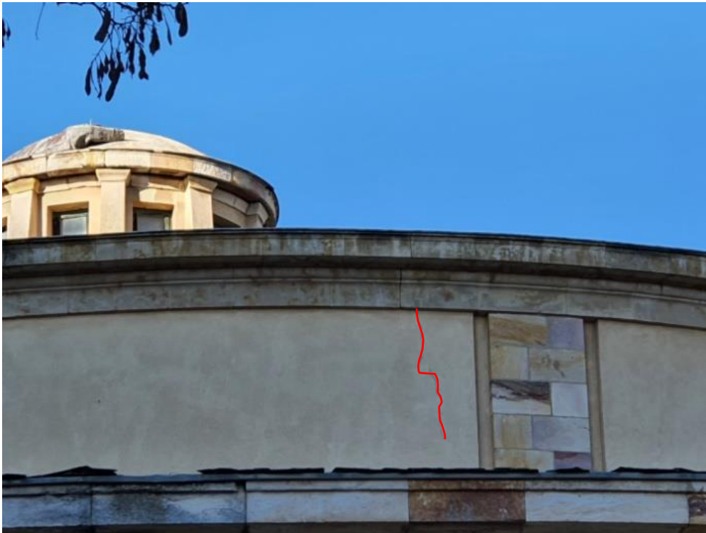
FOTO 7 – Vista general de fisura vertical en el muro perimetral que forma el apoyo de la cúpula central del edificio.
