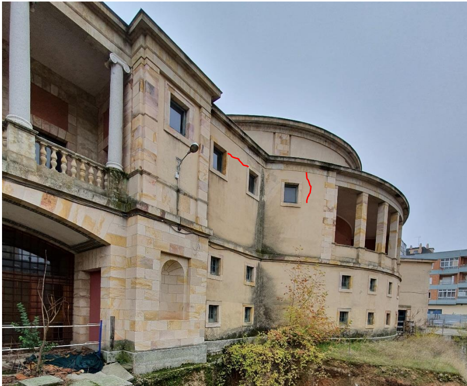
FOTO 2 -Vista general donde se observan una fisura vertical y otra horizontal, y moho y hongos por la escorrentía del agua por la fachada.
