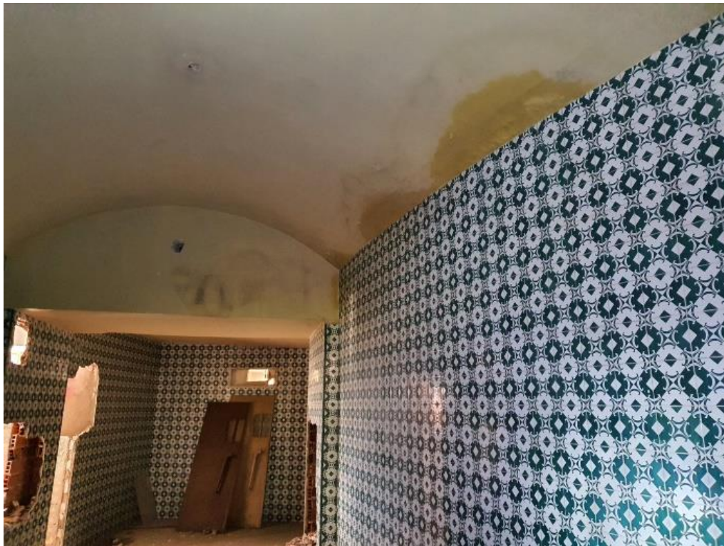
FOTO 4 – Mancha de humedad por posibles filtraciones de agua en la bóveda de cañón. Techo de Planta Baja.
