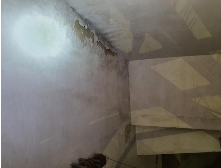
FOTO 17 – Humedad por posibles filtraciones de agua desde la cubierta sobre el escenario.
