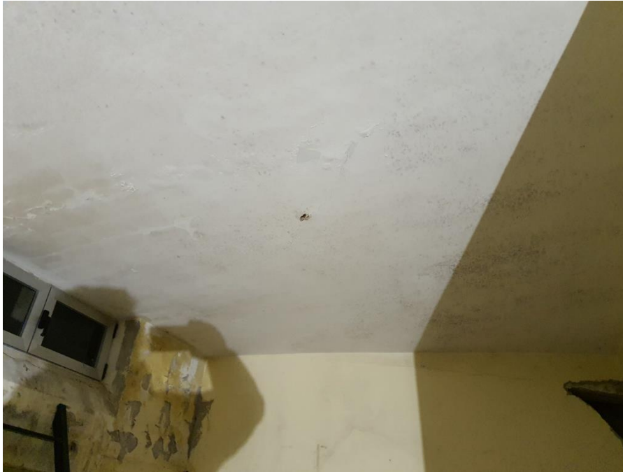
FOTO 13 - Humedad por posibles filtraciones de agua desde la cubierta del edificio. Techo de bajo cubierta.
