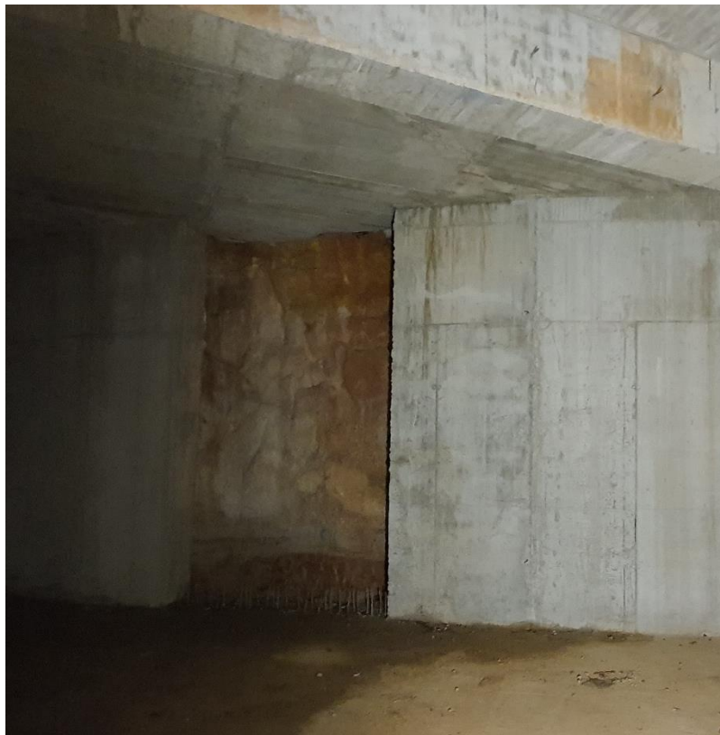
FOTO 4 -Vista general donde se observa fisura vertical. Muro 4.
