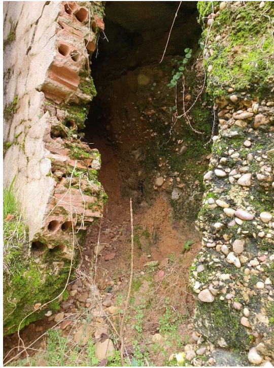
FOTO 1 –Detalle de deslizamiento del talud.
