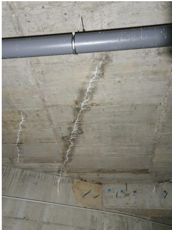
FOTO 12 -Vista general donde se observan fisuras horizontales con eflorescencias por sales en la cara inferior del techo del sótano -1
