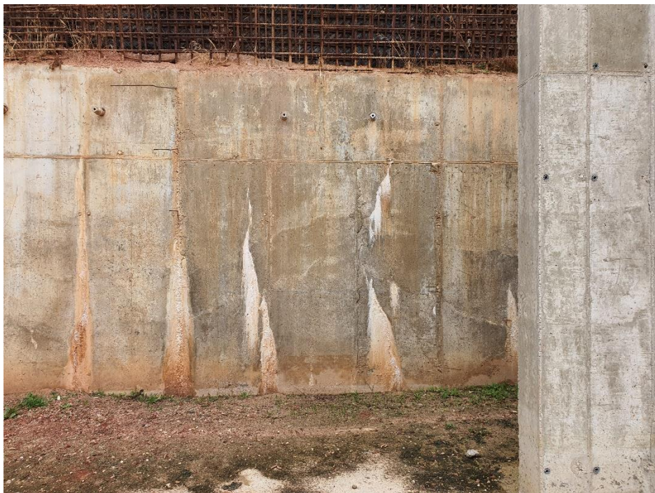
FOTO 2 -Vista general donde se observan fisuras verticales con eflorescencias por sales. Muro 2.
