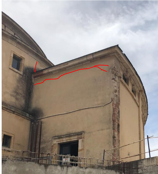
FOTO 3 -Vista general donde se observa una fisura horizontal y otra vertical, moho y hongos por la escorrentía del agua en la fachada.
