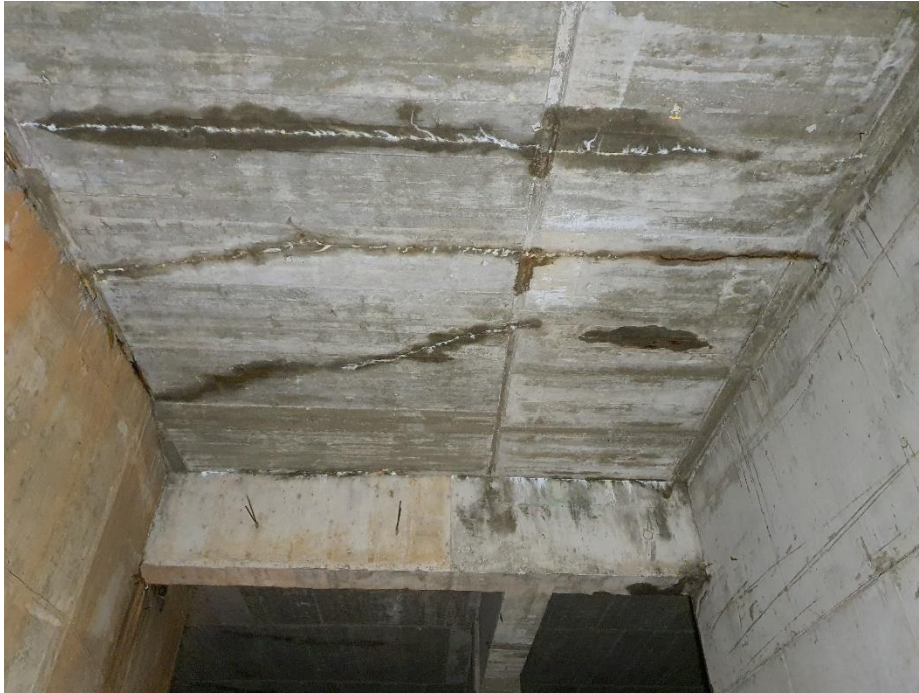
FOTO 7 -Vista general donde se observan fisuras horizontales con eflorescencias por sales en la cara inferior del techo del sótano -2.
