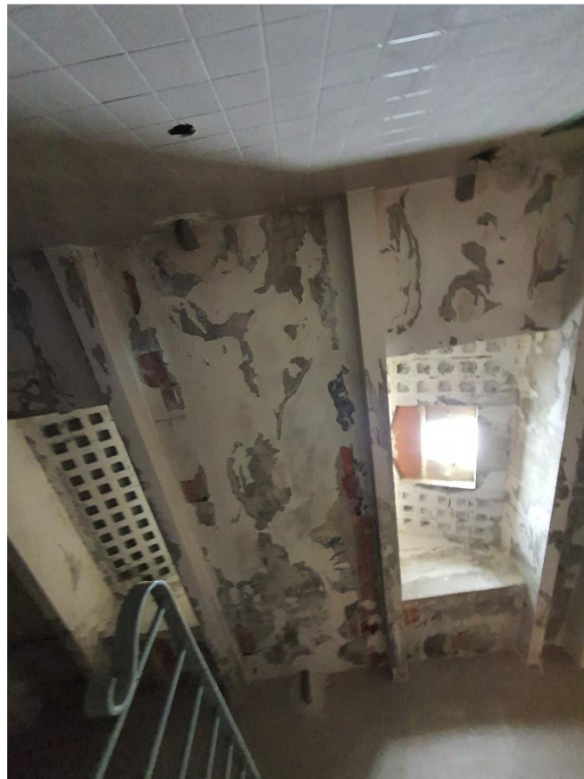
FOTO 14 - Humedad por posibles filtraciones de agua desde la cubierta del edificio. La armadura presenta corrosión. Techo de bajo cubierta.
