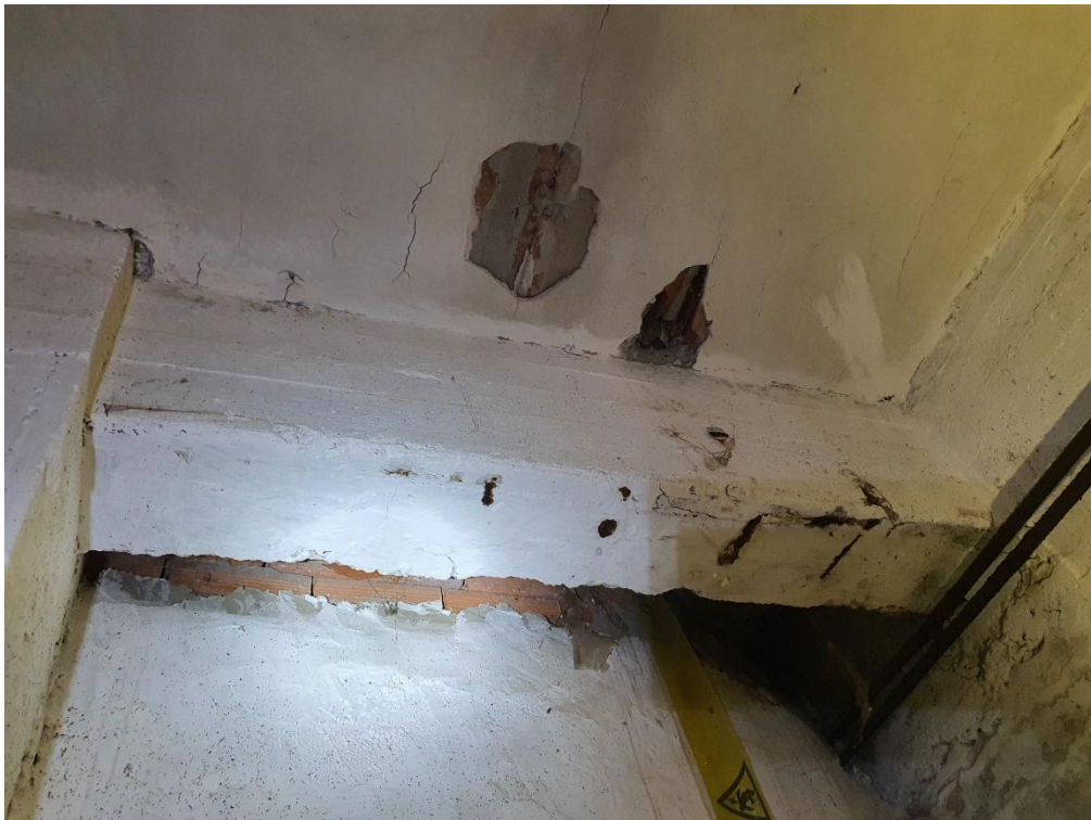
FOTO 1 - Vista general de armadura vista y corroída tanto en la cara inferior del forjado como en la cara inferior de la viga de cuelgue. Techo del sótano bajo el vestíbulo.
