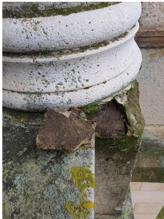
FOTO 12 –Detalle de desprendimiento de la piedra. Se observan hongos y moho.
