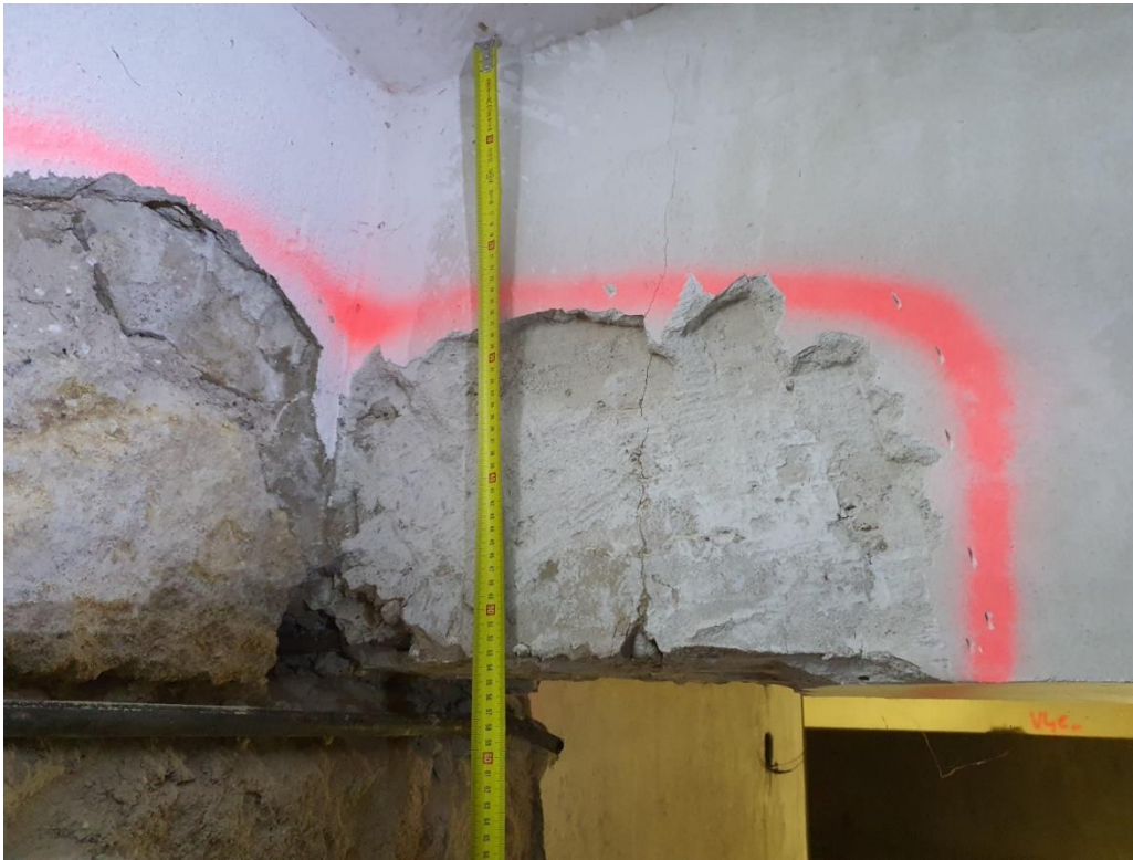
FOTO 3 – Fisura vertical por posible fallo a cortante y apoyo en muro deficiente. Techo del sótano bajo el escenario.
