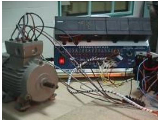
Conexión motor Dahlander y cableado de autómeta
