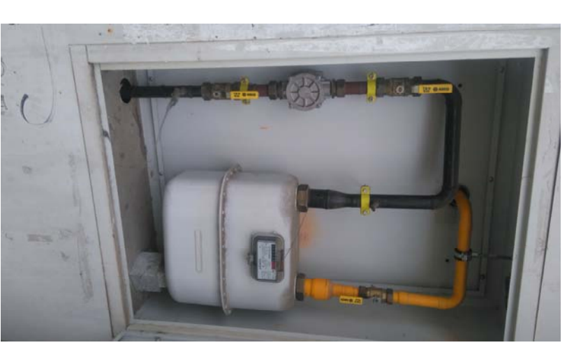
Homacina con contador de gas existente a sustituir
